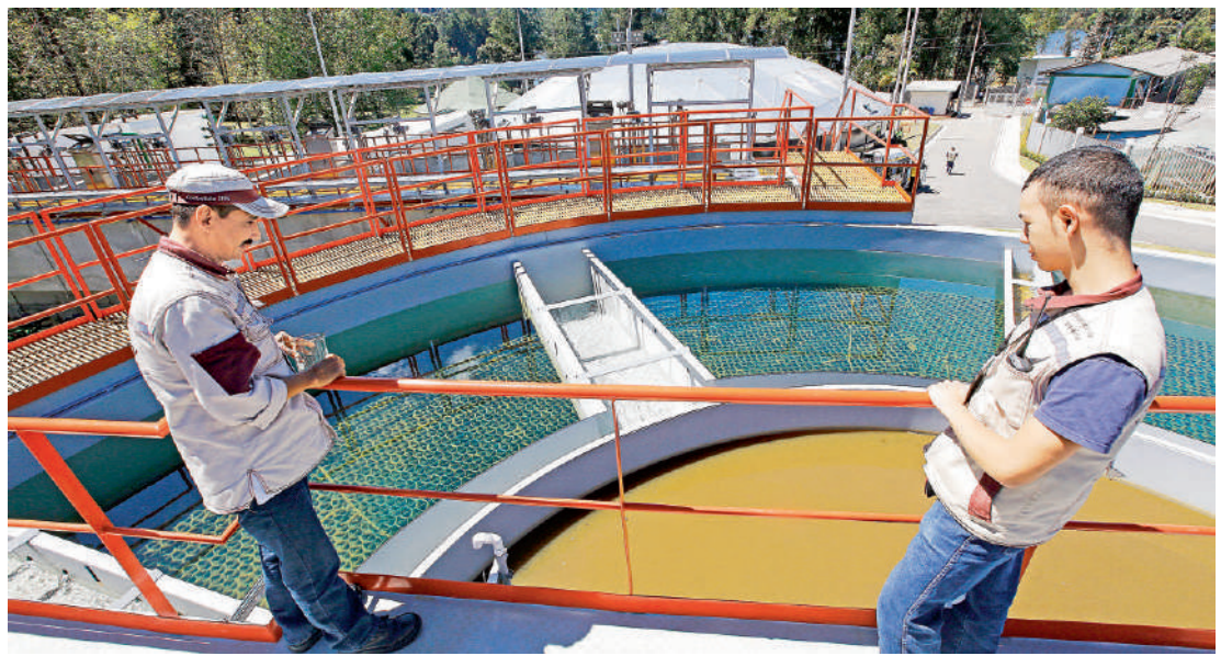
EPM construyó una moderna planta de potabilización de agua en el parque Los Salados (El Retiro). FOTO MANUEL SALDARRIAGA
